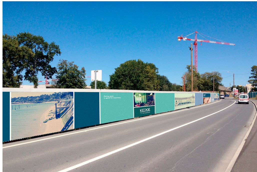
Habillage de palissade pour travaux /// Kedge Marseille /// Impression numérique sur bâche Longueur totale ≈ 100 m en 24 bâches de 4 x 2 m
